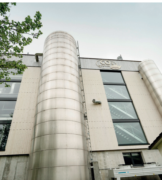
Der Heisswasserspeicher der Holz-schnitzelheizung misst über 18 Meter und fasst 200 000 Liter Heisswasser.
